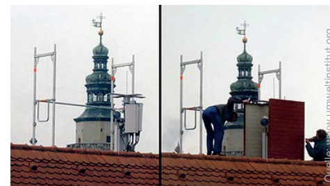
Gut einpacken: Eine Sendeanlage auf einem Münchener Dach wird als Kamin getarnt.
