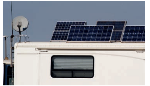
Elektromagnetische Felder entstehen im Wohnmobil beispielsweise auch durch Solarzellen.
